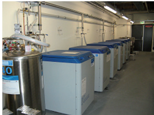
Centrale cryo-ruimte in M379 op laag -2
