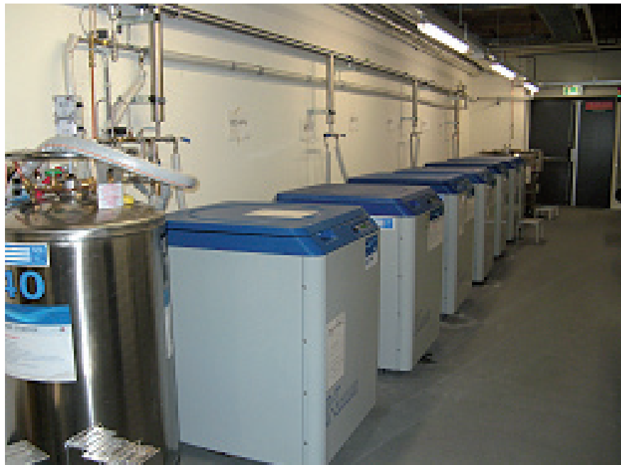
Bewaarvaten voor droge opslag, dus opslag in de dampfase Cryo-ruimte in M379 op laag -2
